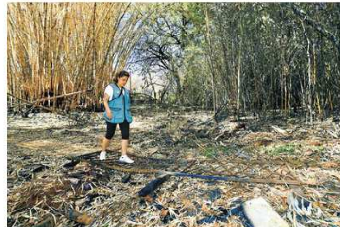
Apenas a armação de ferro sobrou da pequena ponte sobre um dos córregos que dão origem ao Arrudas. Onde corria o leito restaram somente folhas secas e restos de vegetação queimada
